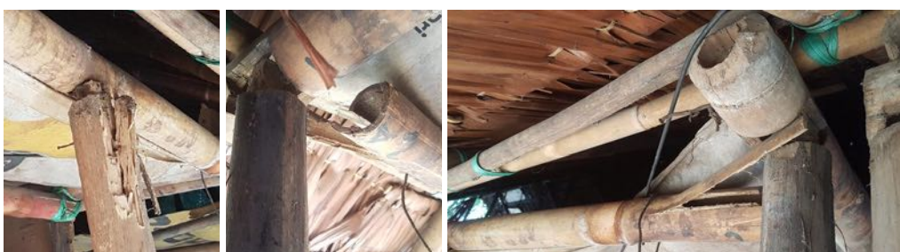
Gambar 10. Kondisi struktur yang rusak (Dokumentasi penulis, 2019)
